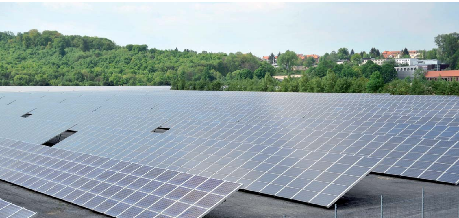
Photovoltaikanlage auf dem Gelände der ehemaligen Grube Göttelborn
